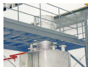
料仓过滤器 Bin filter
